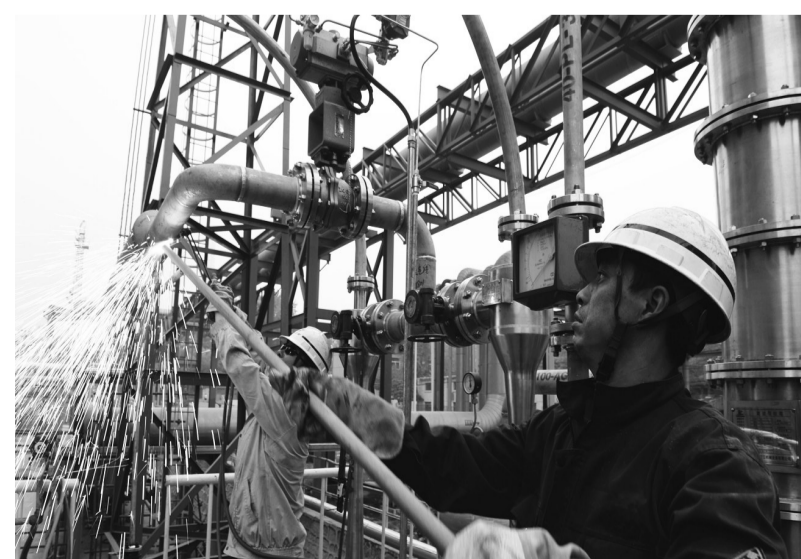
燕山石化投资8亿元实施“碧水蓝天”项目,包括VOC、动力锅炉、工业废气脱硝、区域异味等治理工程。图为酸性水储罐脱硝气脱臭项目施工。 胡庆明摄
