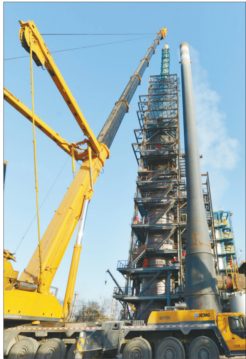
作为中国石化“碧水蓝天”重点工程之一,河南濮阳中国石化中原石油石化总厂烟气脱硫脱硝装置将在月底投运,项目投运后,每年可减排二氧化碳600余吨、氮氧化物100余吨。
