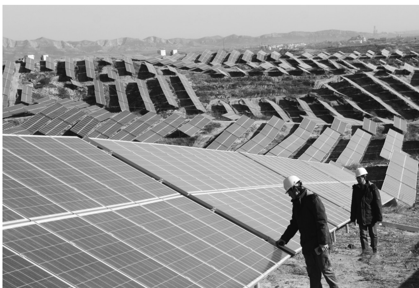
扩大光伏产业规模化应用是河北省优化能源结构的一个重要方向。图为河北省临城县建设的地面光伏电站。周迎久供图
