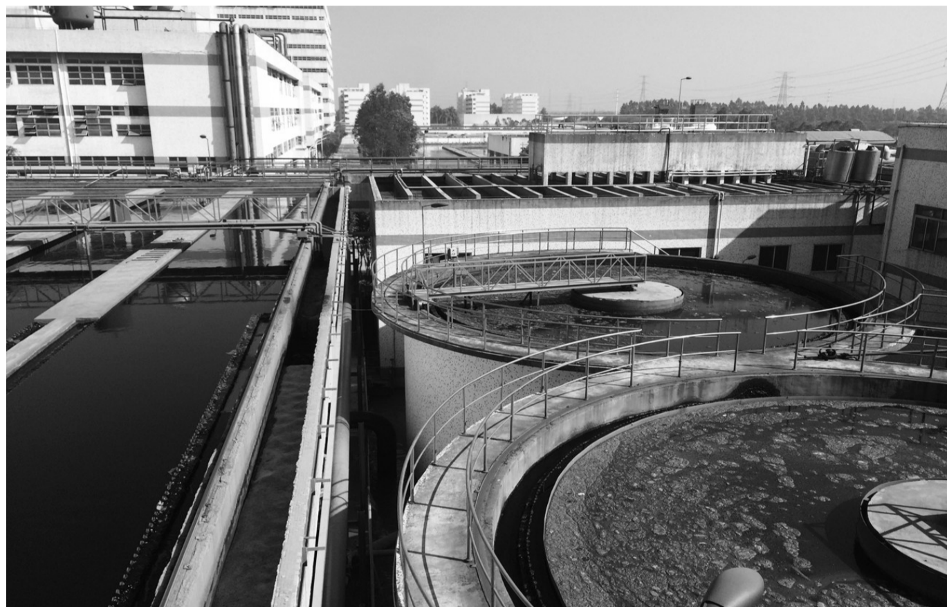
图为互太印染污水处理设施。 本报记者徐卫星摄
