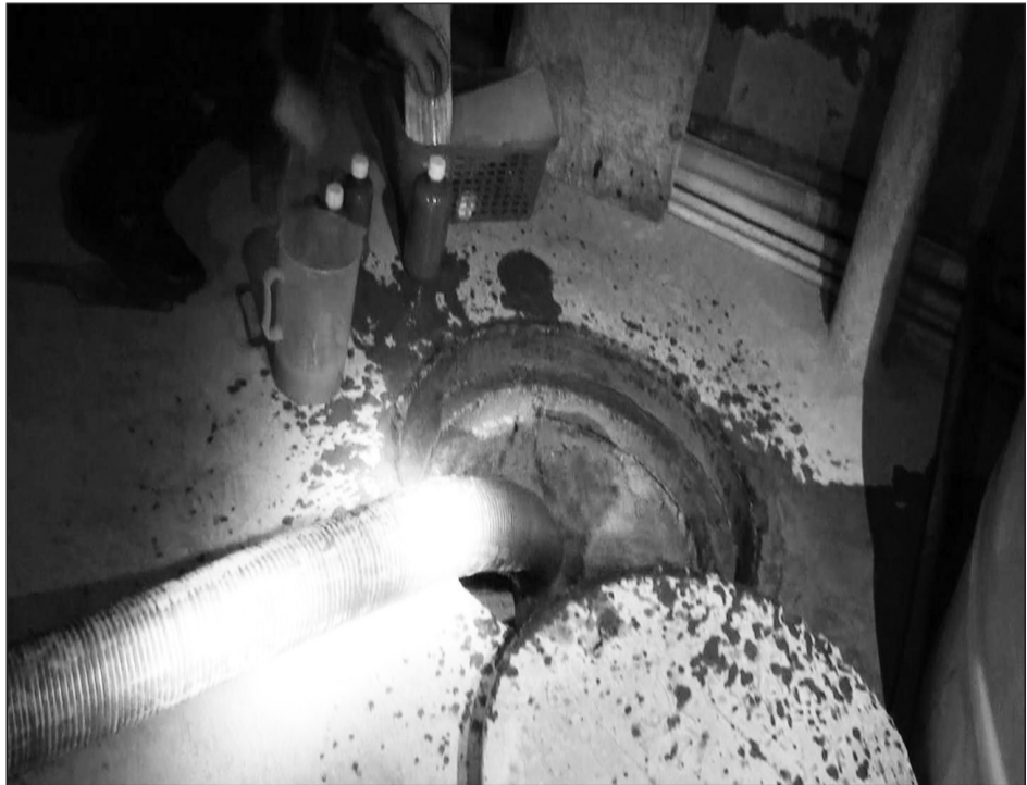
图为恒进五金的超标废水直排市政污水管道。
