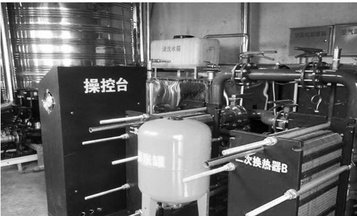
图为东坡煤矿的空压机余热回收设备
