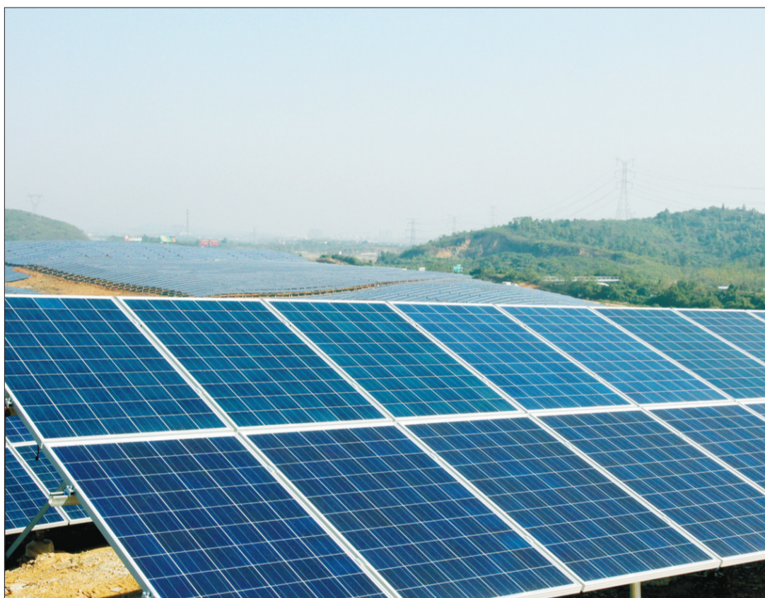
位于安徽省芜湖市三山区峨桥镇的35千伏信能光伏电站,今年一季度发电量达1646万千瓦时。此电站是皖南首个地面光伏电站,总投资9.22亿元,每年可节约标准煤3.2万吨。
