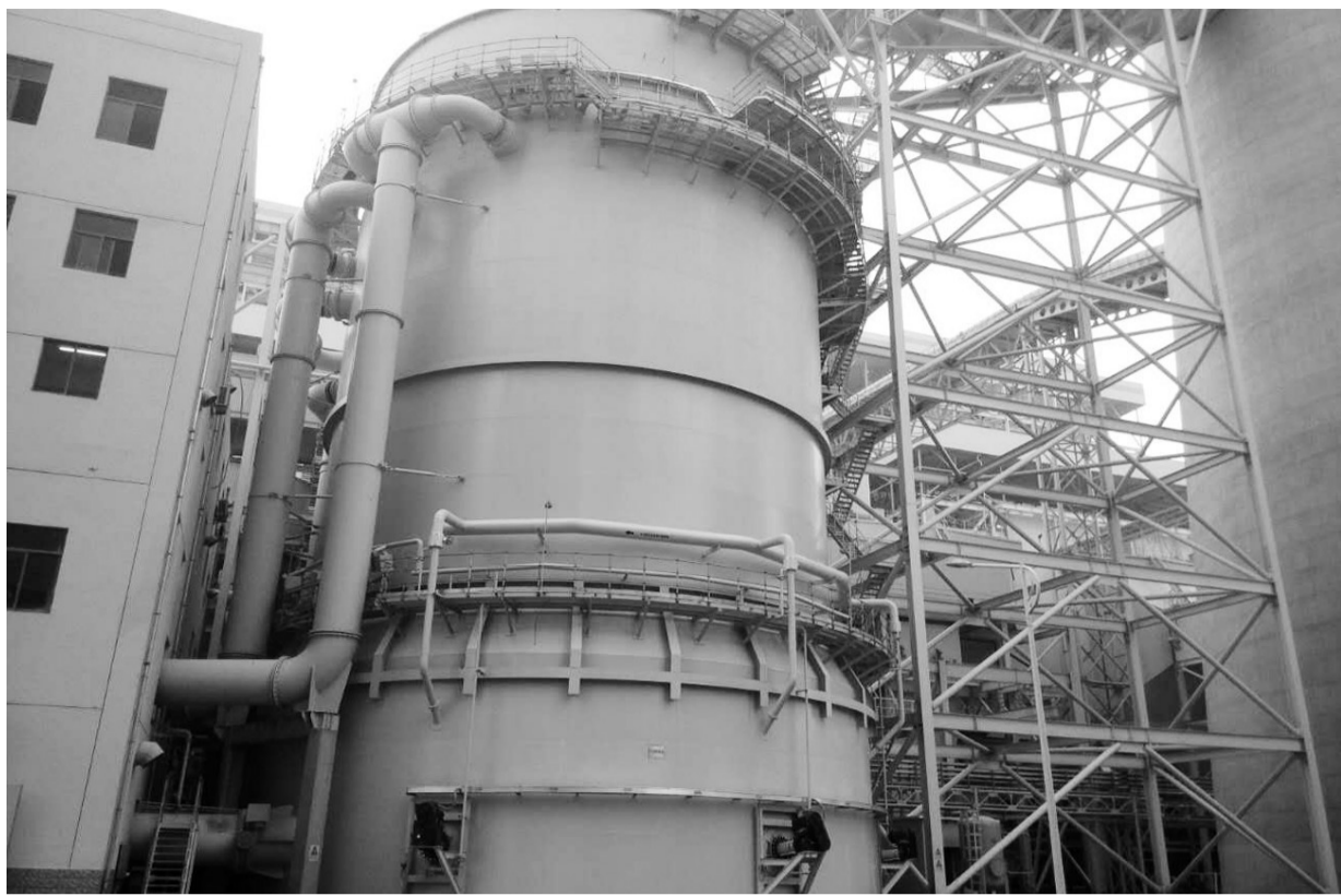
图为神华神皖安庆皖江发电有限责任公司3号机组的一体化脱硫除尘塔(采用SPC-3D技术)。
