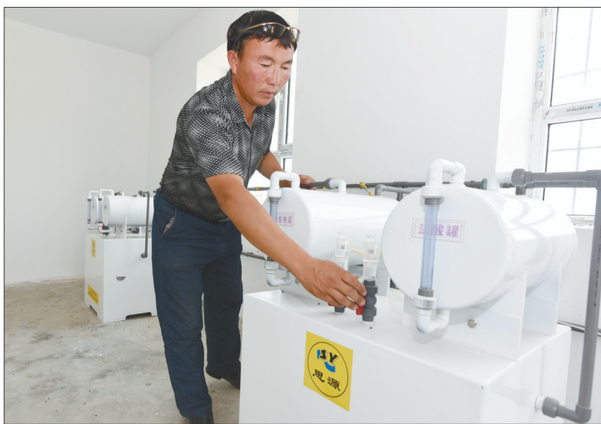
铁热克提村供排水工程供水站站长、41岁的木合亚提,正在检查供水站设备。该系统可为226户、800多村民供水,同时可日处理150吨生活污水。
