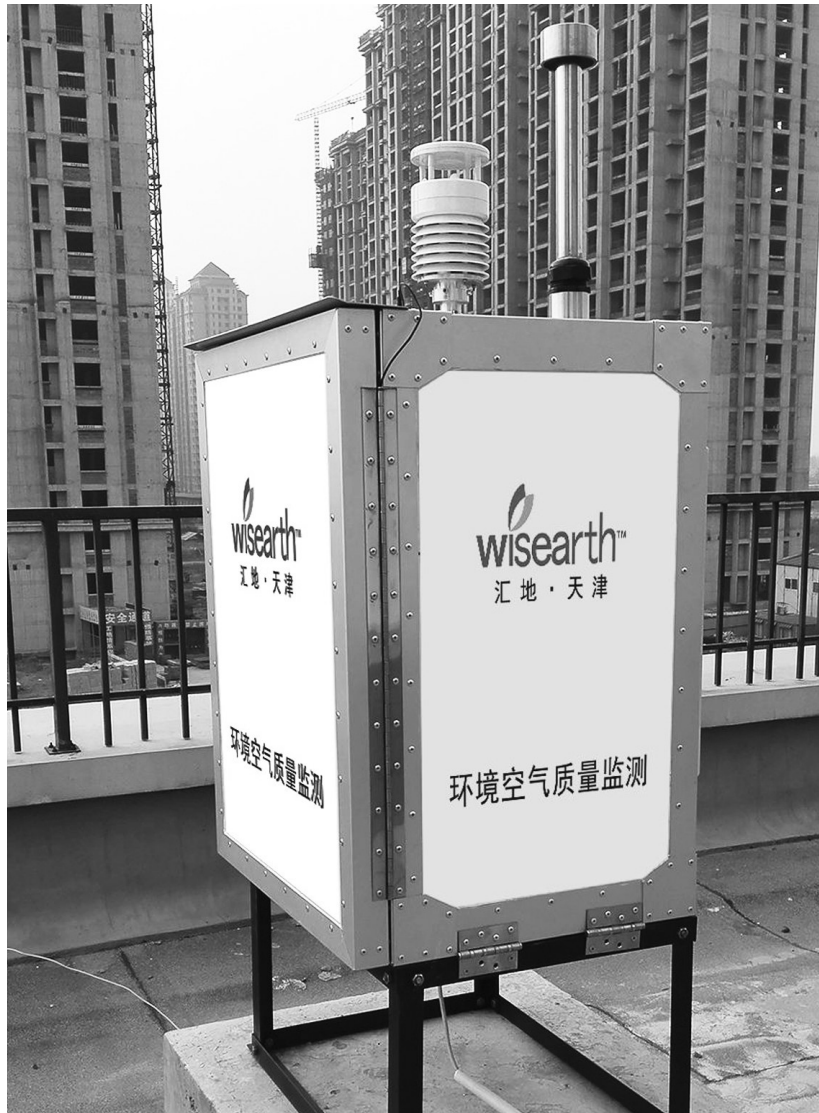
天津北辰区在其所辖的9镇、7街、一开发区共设置了18个空气质量监测点,每个点位安装一台数据监测仪器,仪器实时把采集的数据通过无线网络传输到安装在区环保局的中控平台,中控平台通过分析数据,显示各监测点质量状况和污染情况。图为安装在青源街道的监测仪器。 本报记者张杰摄
