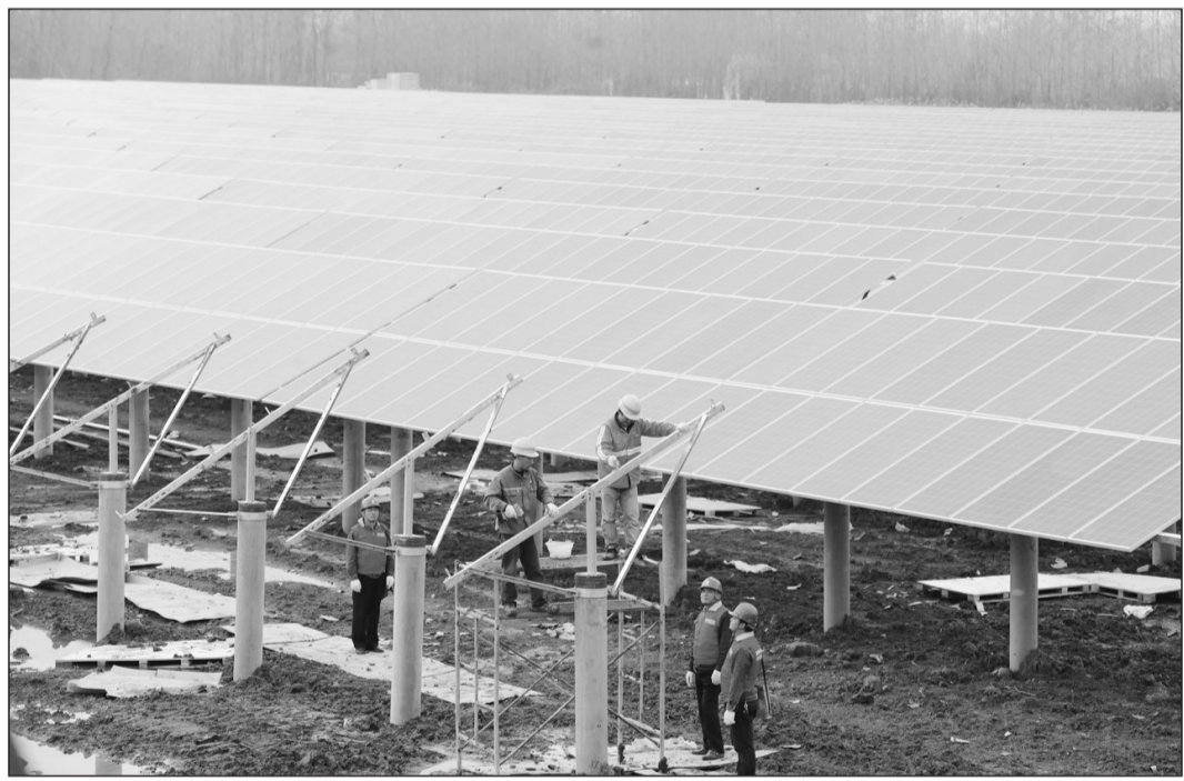
安徽省天长市牧马湖在建的一期20兆瓦“渔光互补”发电项目总投资1.8亿元,预计12月建成并网发电,每年并网发电总量可达2200万千瓦时,相当于节煤17800吨。 人民图片网/宋卫星
