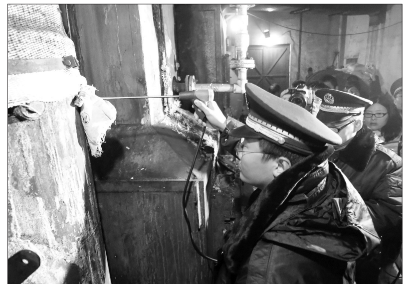
11月30日,北京市启动大气污染防治季夜查专项行动,市、区两级环境监察执法队伍重点对锅炉排放情况、在线监控设备运行情况、燃煤锅炉房煤质情况、重点VOCs排放单位进行检查。图为环境监察人员对通州一小区锅炉房进行检查。
