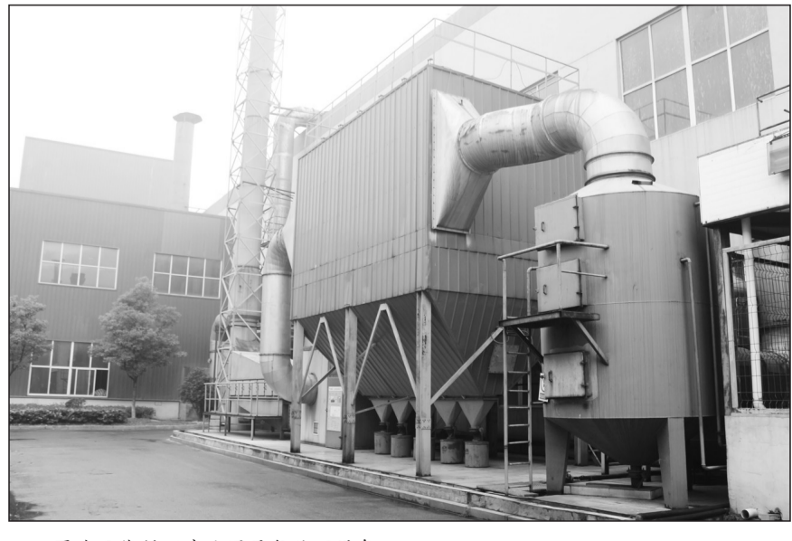
图为天能循环产业园尾气处理设备
