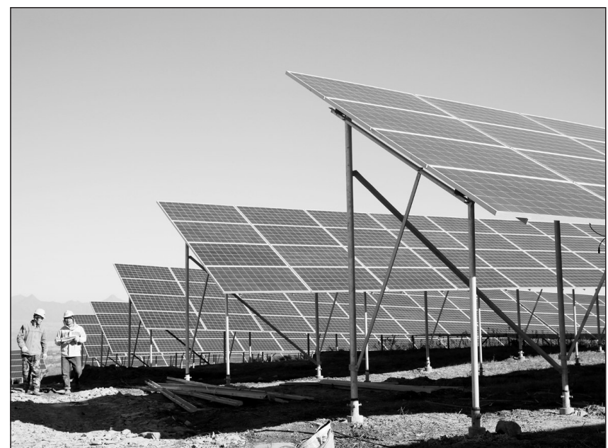
河南省三门峡市辉润光伏发电有限公司20MWp分布式光伏并网电站建设项目,利用太阳能光伏发电无污染零排放的特点,与当地农业生产有机结合,满足农业生产的需要,实现光电转换,创造了全新的农业生产经营模式。
