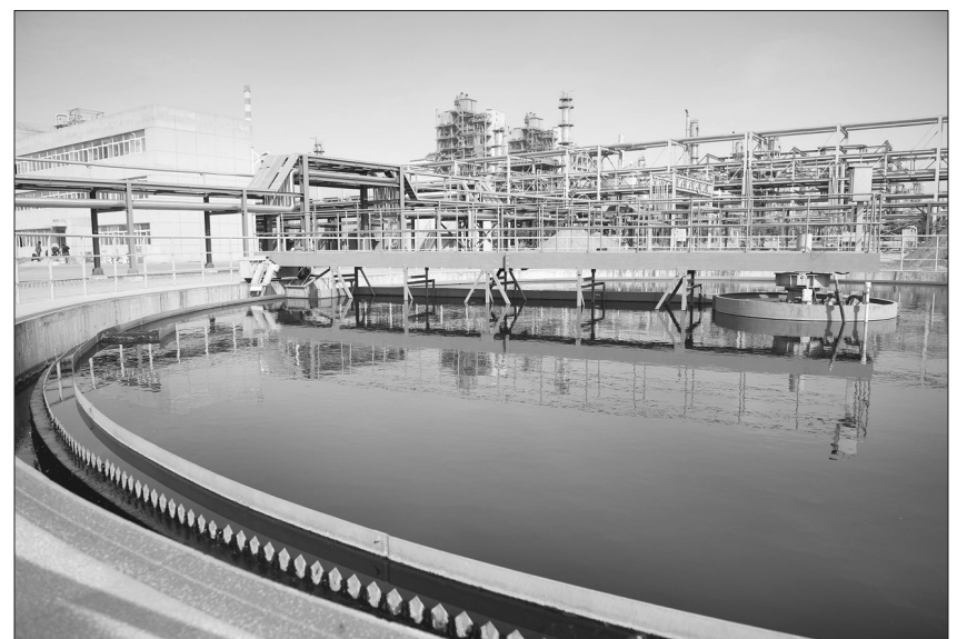
神华鄂尔多斯多斯煤制油项目是煤炭直接液化商业性建设项目,国家“十一五”计划的重点项目之一。博天环境采用MBR工艺,历经近9个月的中试,调试出一套最经济适用的工艺模型,实现了对不同水质质量污水的达标处理。
