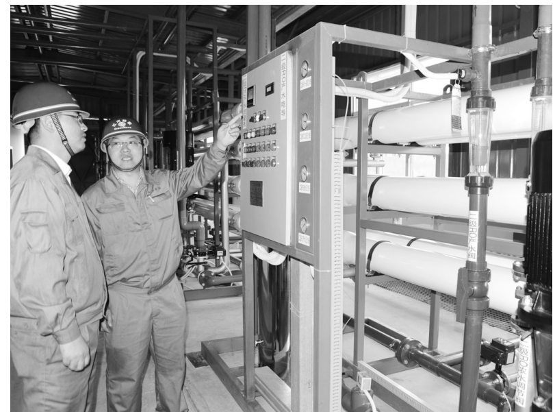
位于云南省个旧市的鑫联环保科技有限公司,长期致力于固废物炼铁烟尘资源化综合利用,为促进当地重金属污染防治发挥了重要作用。图为公司新建投运的废水资源化利用设施。 蒋朝晖摄
