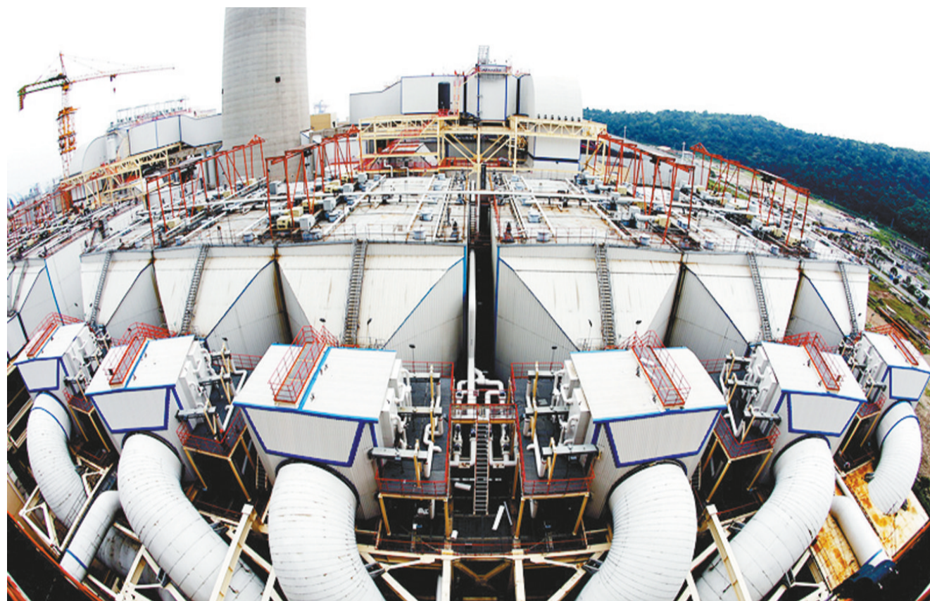
浙能嘉兴电厂三期8号机组超低排放系统设备。
