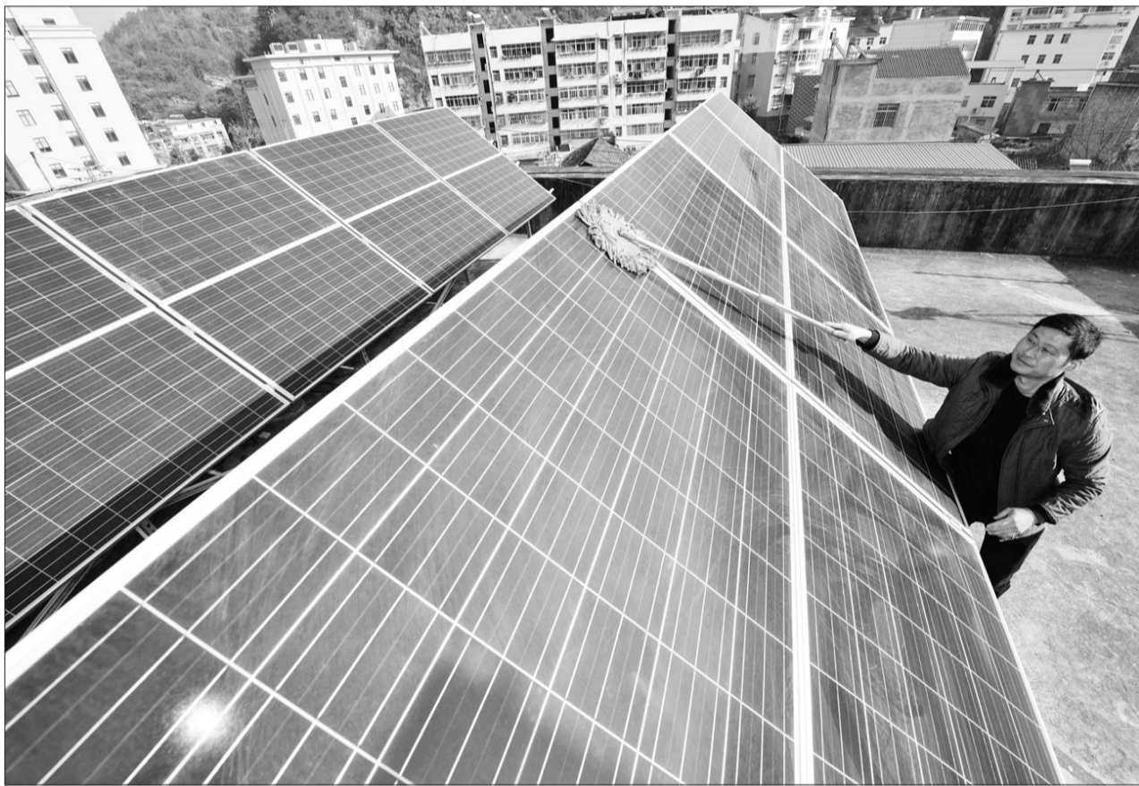
湖北省保康县城关镇城南社区居民袁俊林近日投资5万元,在自家屋顶上安装了20块光伏电池板,建成了一个小5.2千瓦的光伏发电站,并成功并入国家电网。据了解,通过建设这个小型光伏发电站,袁俊林不但实现了自家用电自给自足,还将剩余电量卖给国家。 人民图片网供图
