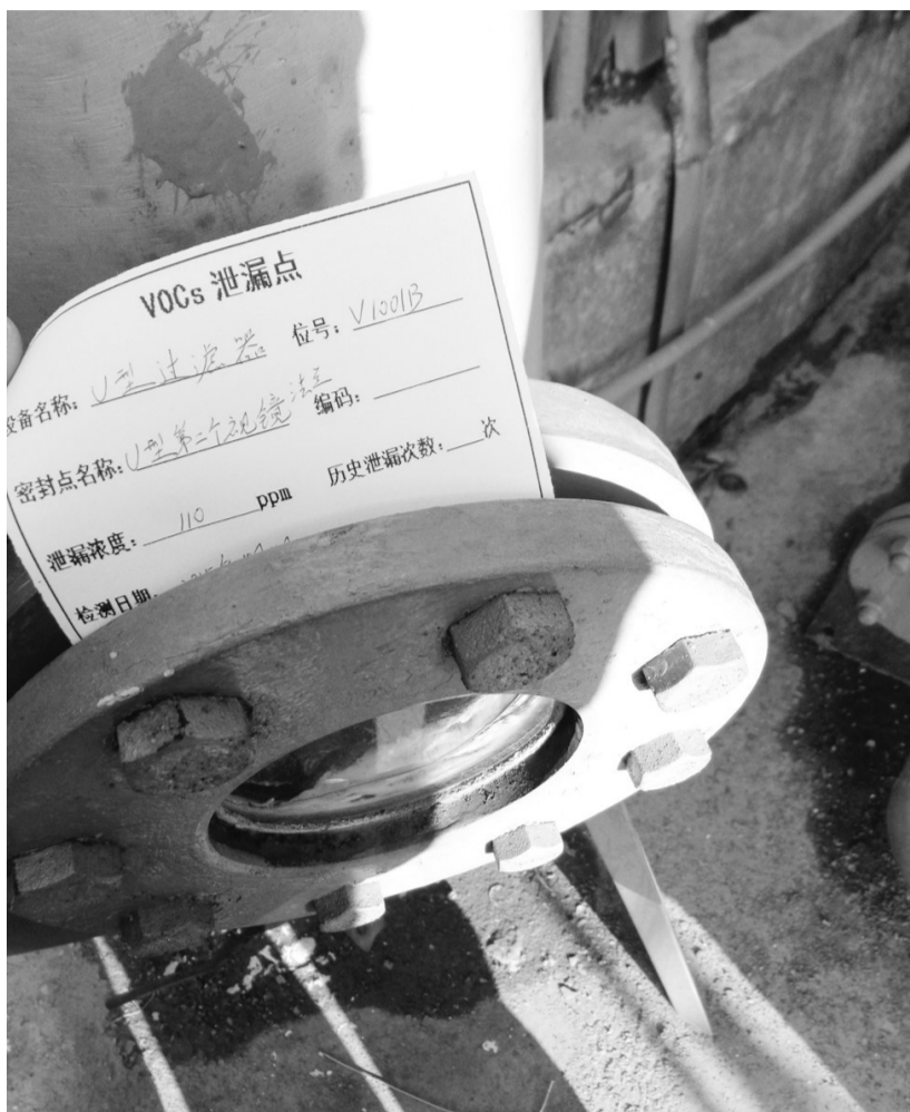
检测人员检测出泄漏点,挂上红色标识牌,企业便立即开展修复。标识牌上显示设备名称、密封点名称、泄漏气体浓度和历史泄漏次数等内容。
