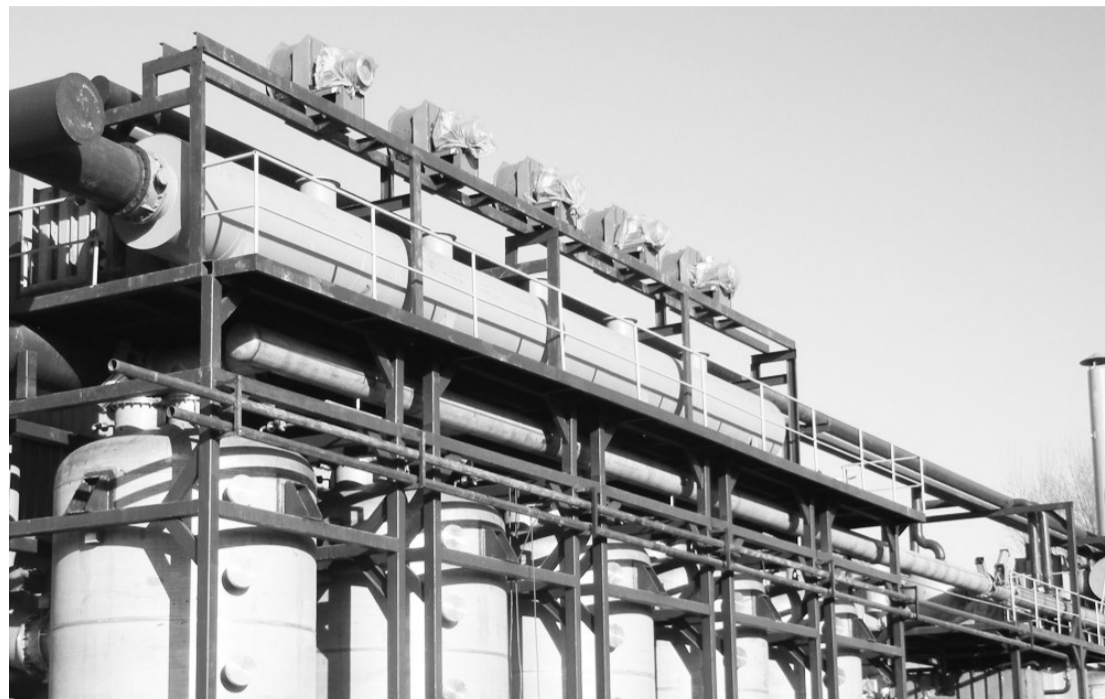
专家建议,可将一套吸附设备对应多条生产线,以降低设备投资和运行成本。只有成本降下来了,排污企业能够接受,才会主动选择这种服务,这种治理模式才能尽快推广。因为在河北雄县试点企业安装的VOCs吸附冷凝回收装置。 本报记者张杰摄
