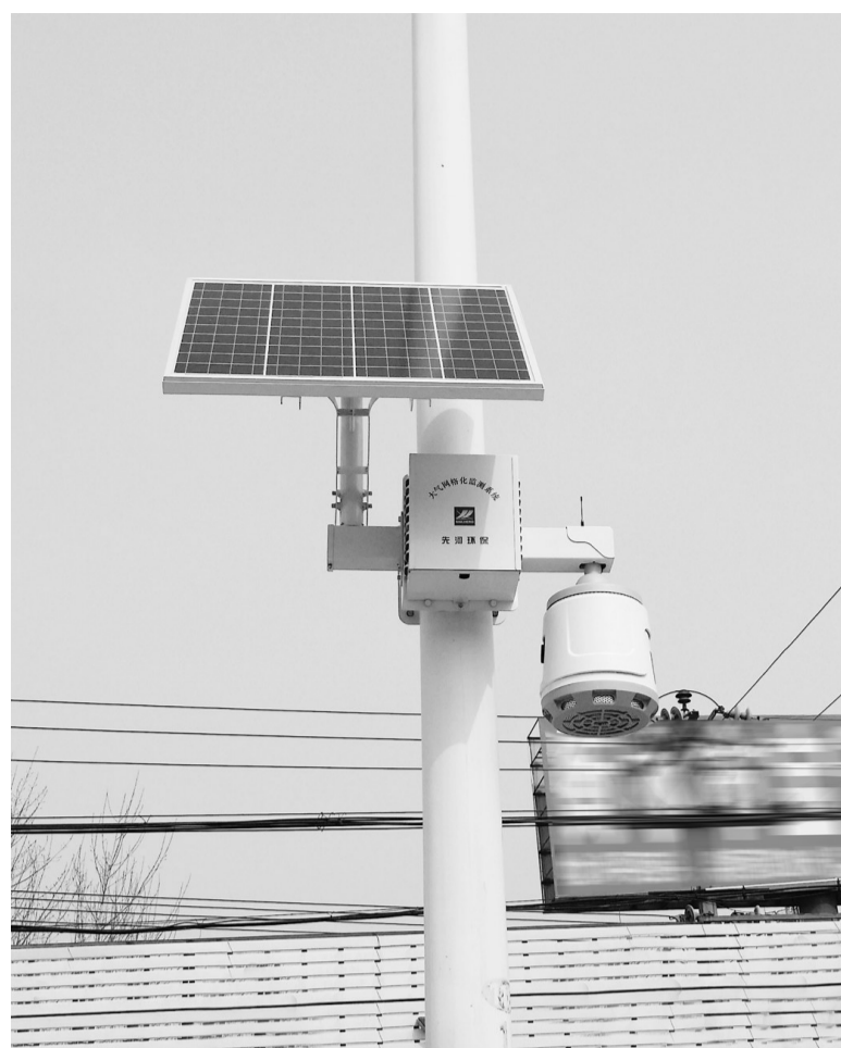
空气网格化监控系统在提供PM 10 、PM 2.5 、SO 2 、NO 2 、CO、O 3 等6项参数数据基础上,可扩展对VOCs、氯气、硫化氢、氨气等多种特征污染物进行监测。图为先河环保公司安装在某市道路上的空气质量微型站,用以监控交通污染状况。
