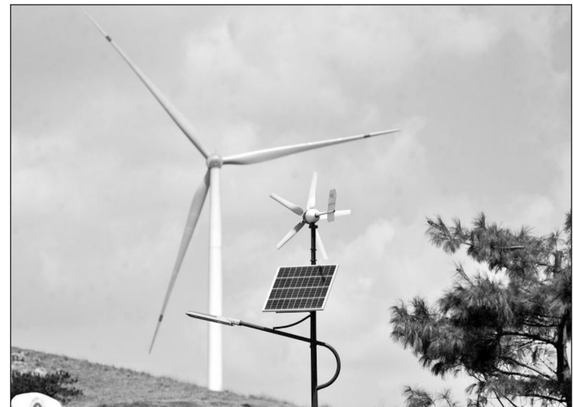
湖北省宜昌市夷陵区百里荒风电场110千伏上网线路工程自2015年10月竣工投产以来运行平稳。项目总投资4.4亿元,每年可提供1亿千瓦时的绿色电力。图为百里荒风电场发电设备。 人民图片网供图
