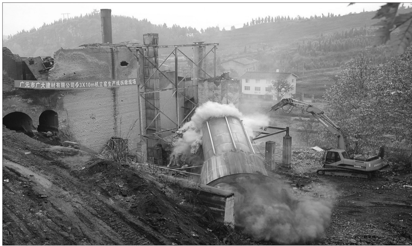
广元大力调整产业结构,淘汰了许多污染企业。图为利州区拆除大石立窑水泥厂。资料图片
