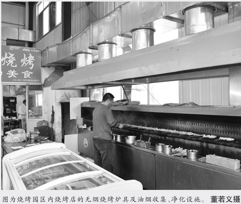
图为烧烤园区内烧烤店的无烟烧烤炉具及油烟收集、净化设施。董若义摄
