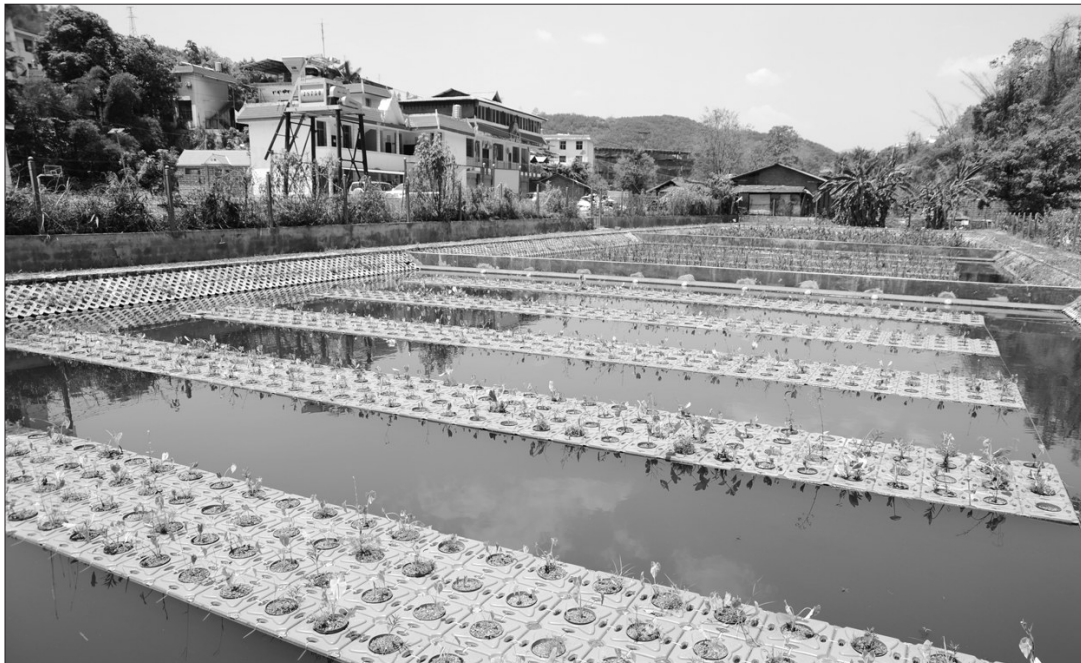
云南省勐腊县象明彝族乡的生活污水处理系统2013年建成投运,目前系统管护良好、运行正常。
