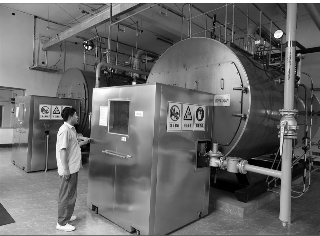
北京市延庆区紧紧围绕服务世园会和冬奥会,从减煤换煤入手,积极推广新能源、新技术,改善能源结构,2015年底,新能源和可再生能源占全区能源消费总量的30%,利用3年时间完成全区881台1785吨燃煤锅炉和小煤炉改造。图为北京华润高科制药有限公司煤改气项目。 本报记者邓佳摄
