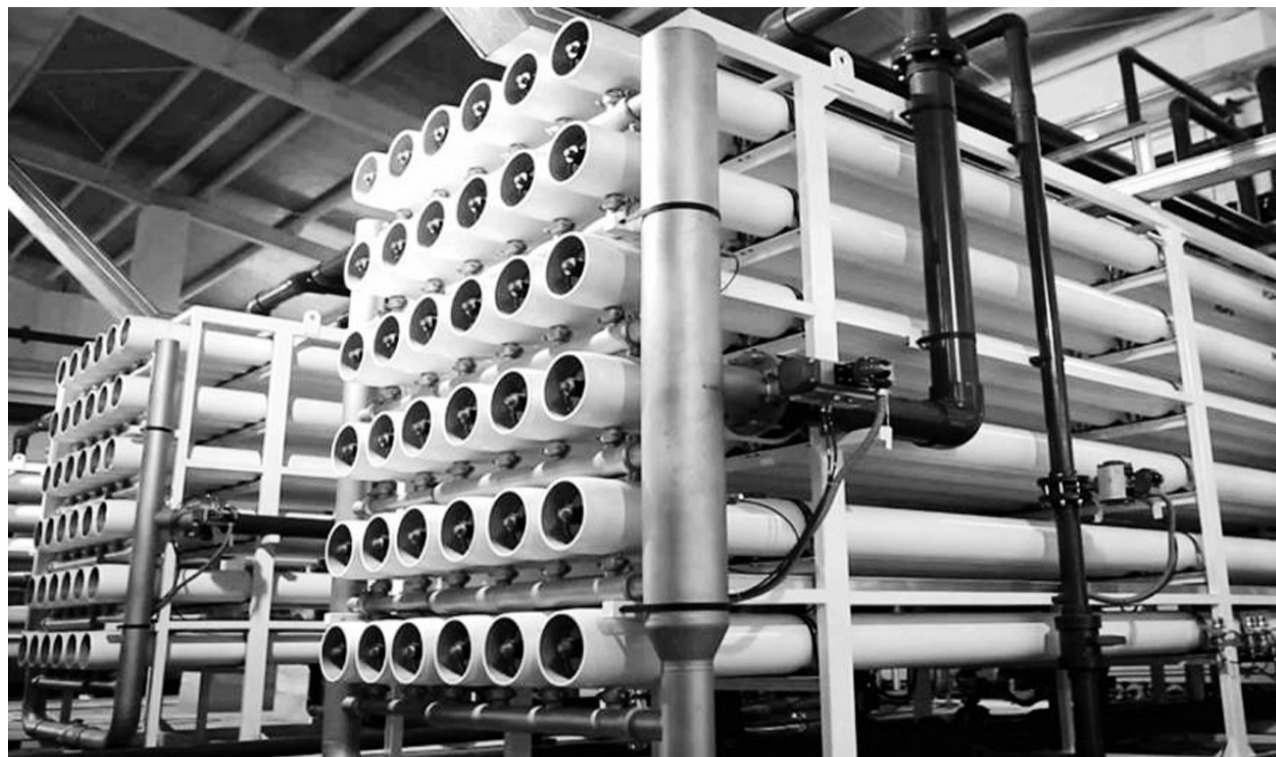
在生产环节,通过深染色水分流控制、高浓度PVA水单独收集处理,减轻了后续污水处理站的负担,同时实现特殊物料回收再用,其中液氨回用率为98%以上。图为鲁泰的废水双膜法回用项目。
