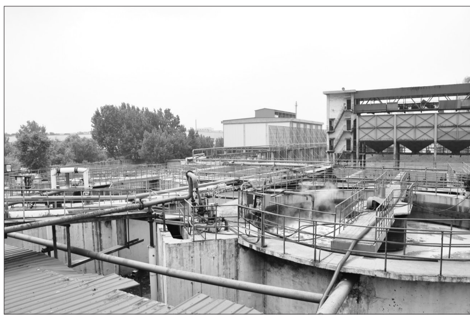
图为正大焦化污水处理设施。日前,公司新建设的熄焦废水输送管道已正常使用,经过污水处理设施处理后,再送往熄焦工段重复利用。季英德 董若义摄
