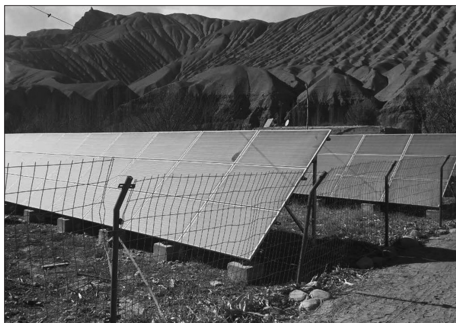
图为“碧波基金”为当地安装的太阳能电站。
