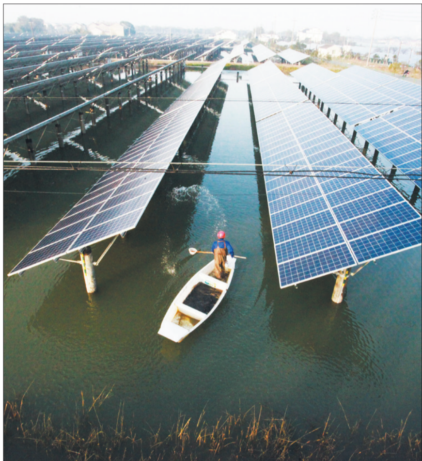
位于浙江省湖州南浔区和孚镇溪东村的湖州祥晖100MW渔光互补项目,占地2800余亩,总投资10亿元,是浙江省单体最大的渔光互补项目,实现了水上发电、水下养殖、科学开发、综合利用。
