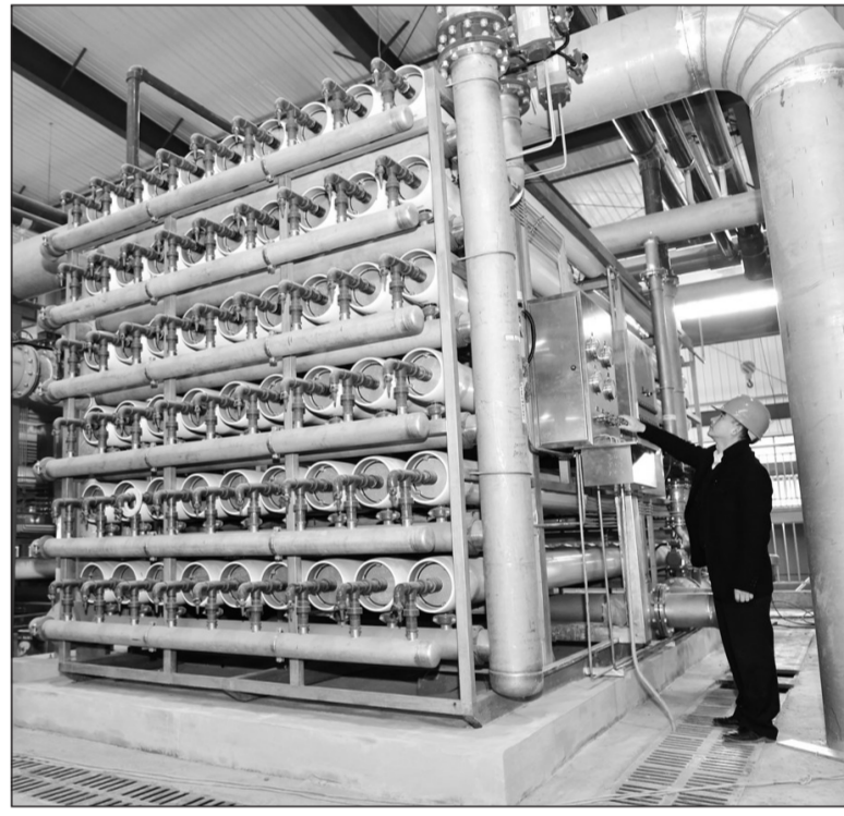
截至1月9日,浙江省中部地区首个高水准的再生水利用工程——义乌再生水利用工程完成土建和工艺设备安装工程,通过污水系统处理后的高品质再生水,将主要应用于义乌经济技术开发区工业用水。图为义乌市第一污水处理厂再生水利用工程现场。 人民网供图
