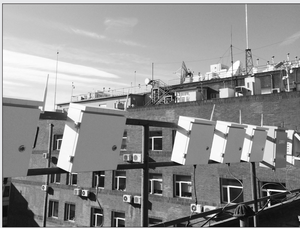
位于北京市环保局楼顶的PM 2.5 微型监测站
