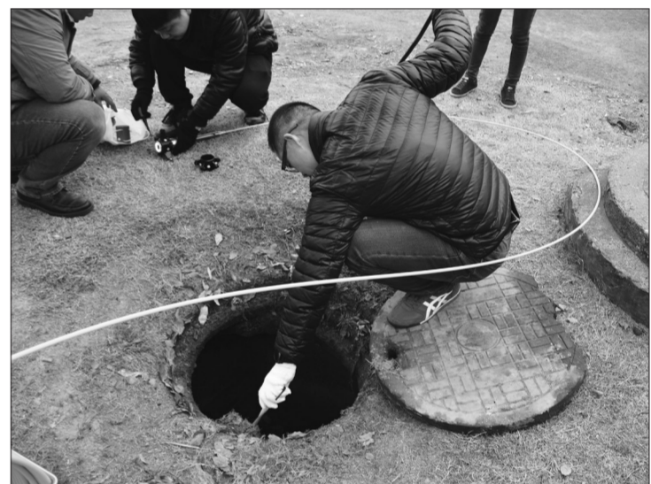
图为环境执法人员利用管道探测机器人进行排查。顾露兰摄
