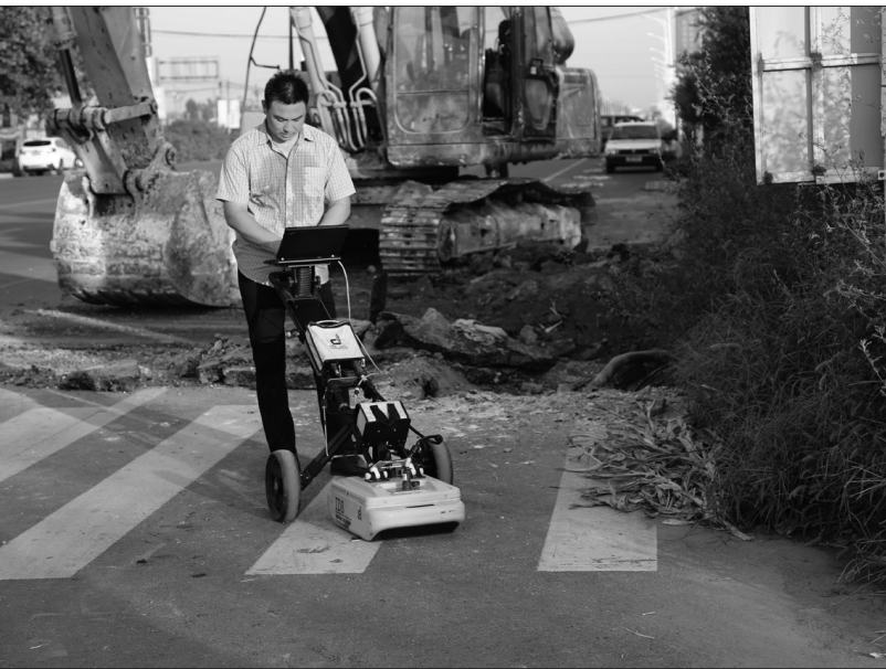
图为执法人员正在排查华星药厂暗排管。
