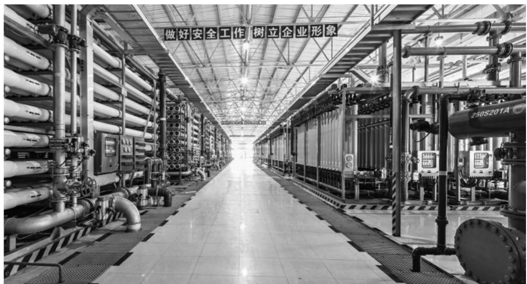
图为陕西未来能源化工有限公司100万吨/年煤间接液化示范项目
