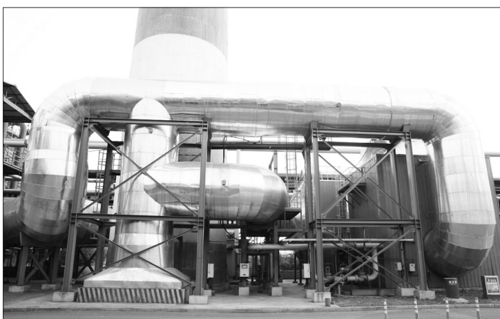
图为江苏爱尔沃特环保设备工程有限公司焦炉烟气脱硝工业装置。
