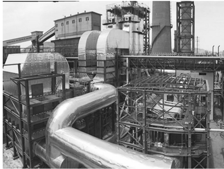
图为美力源焦化厂烟气净化装置全景。
