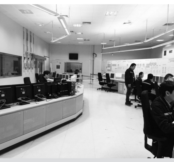
图为田湾核电站中控室。 倪敏摄
