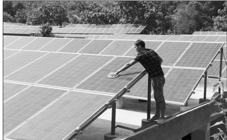
河南省新密市米村镇白槐村村民白清州、白亚州兄弟俩投资40万元购买240块太阳能组件及配套设施,利用自家房顶建起太阳能光伏发电项目。去年8月至今,在保障自家用电的同时,白家兄弟还把盈余的电能卖给国家,收入5万多元。 人民图片网供图
