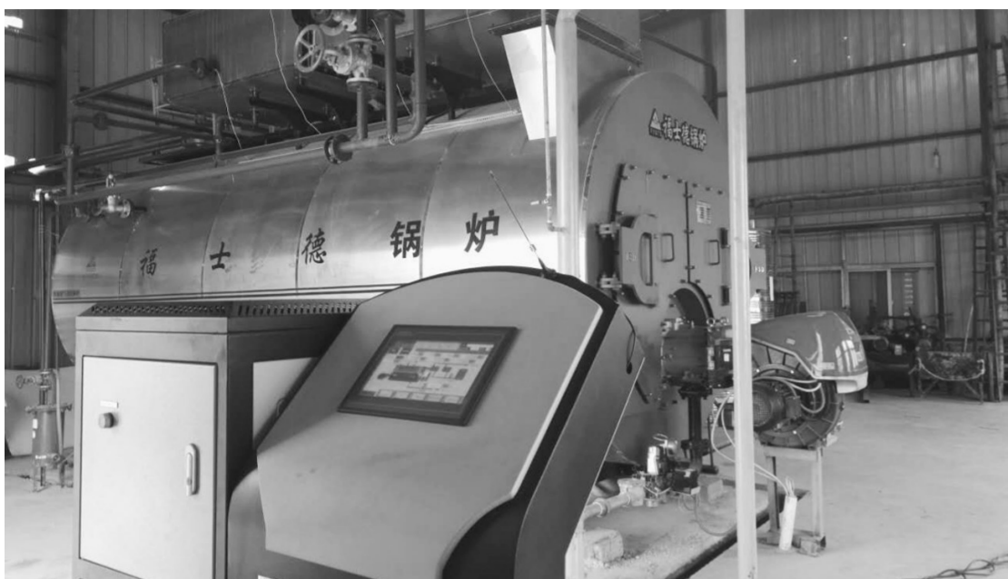
菏泽市在取缔淘汰燃煤小锅炉的同时,积极主动为企业提供服务,解决供热供气难题,推进煤改气、煤改电。图为企业新上的燃气锅炉。
