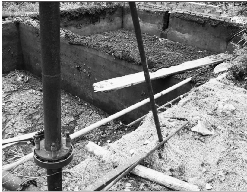
图为臭味熏天、简陋破败的粪便收集池。
