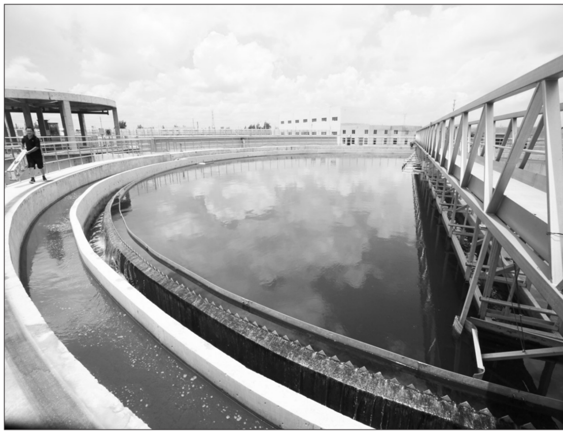
浙江省重点工程——台州市路桥滨海污水处理厂二期改扩建工程近日竣工并正式投入运行。路桥滨海污水处理厂二期工程建成后,日处理污水能力从以前的10.5万吨提高到15万吨,可满足未来3-5年的城市污水处理需求。 人民图片网供图/林宝聪摄
