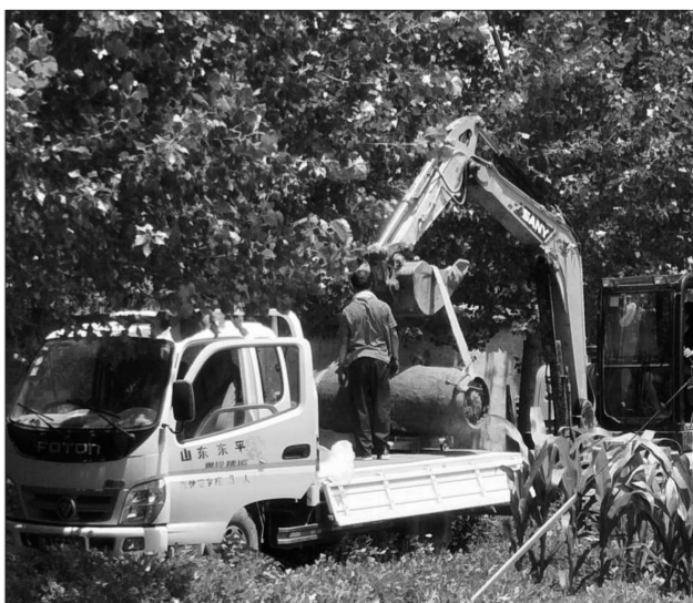
山东省东平县加强危险废物日常管理,不断强化隐患排查,做好危废处置台账工作,严格落实危险废物规范化管理要求。图为东平县环保局工作人员冒着高温挖出某院落非法填埋的废弃氯气罐,送往危险废物处置中心妥善处理。
