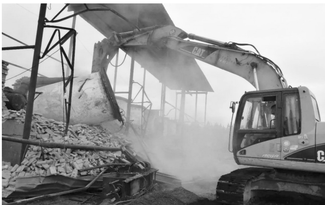
江西省乐平市环保局近日联合鄱阳县环保局、乐港镇政府,出动 30 余名执法骨干,将鄱乐交界处一家生产工艺落后、无环保审批手续、无任何污染治理设施的炼油厂强制拆除。
