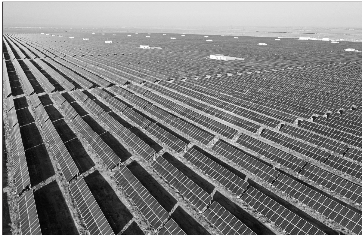
近年来,甘肃省张掖市大力发展清洁能源,建成极具规模的光伏产业园新能源基地。从空中俯瞰,一块块深蓝色的多晶硅板矗立在浩瀚戈壁滩上,宛如身着蓝色军装的士兵,排列得整整齐齐等待检阅。
