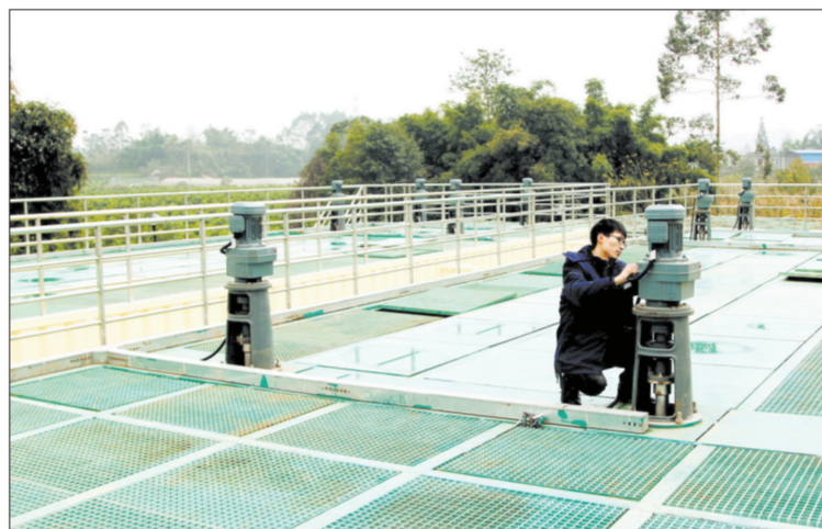
四川省仁寿县近年来持续投入资金22.5亿元用于98座乡镇生活污水处理设施建设。目前,仁寿县首批41座乡镇生活污水处理厂部分已建成并投入使用,到明年底全县将实现生活污水治理全域化。 人民图片网供图
