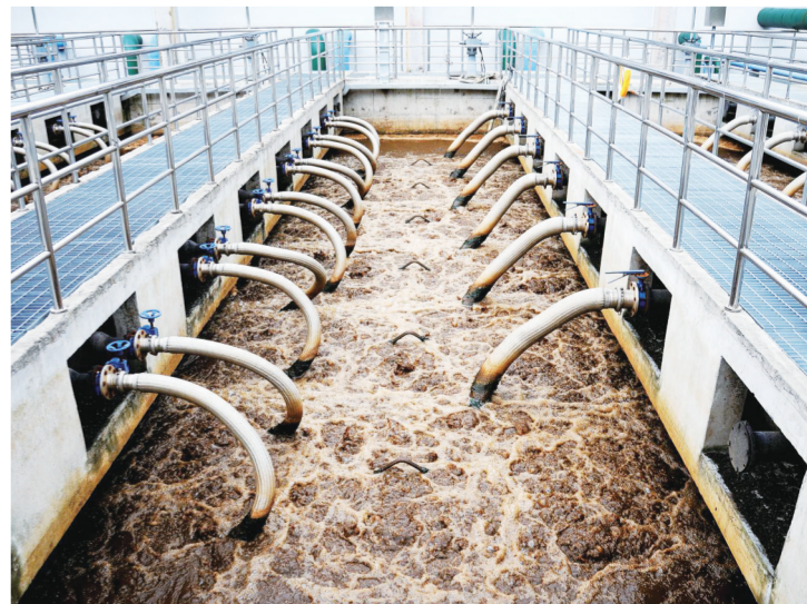
为确保一库净水永续北送,按照湖北省委、省政府“乡镇污水处理全覆盖”要求,十堰市全面启动23座乡镇污水处理厂新建工程和62座乡镇污水处理厂提标升级改造,出水水质由一级B提升到一级A以上。图为提标升级改造后的六里坪镇污水处理厂。 薛乐生摄
