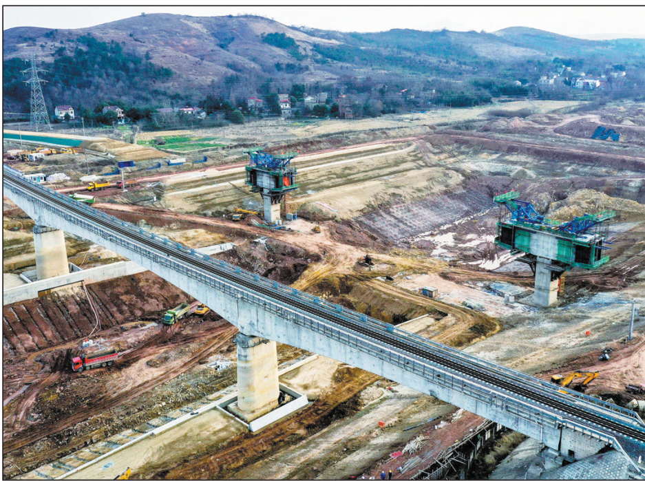
引江济淮是安徽省的基础设施建设工程“一号工程”。引江济淮工程任务以城乡供水和发展江淮航运为主,加强灌溉补水,改善巢湖及淮河水生态环境。 人民图片网供图
