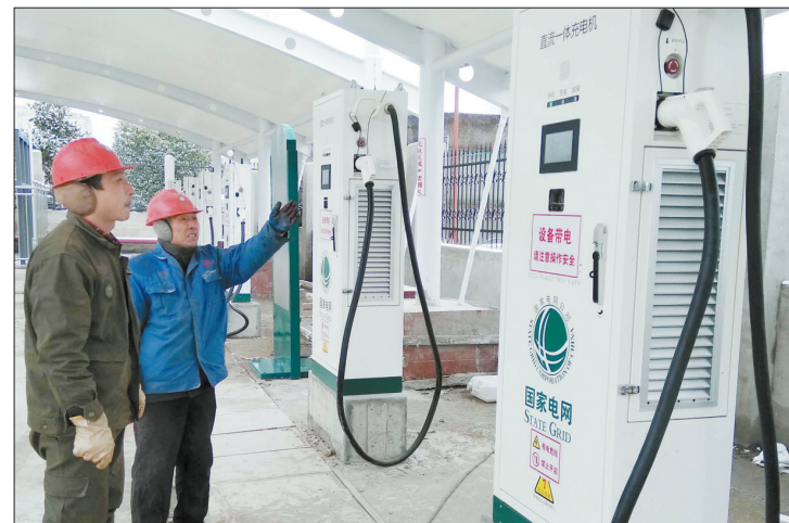
安徽省宿州市淮海南路花园园停车场电动汽车充电站近日投入运营,只需30到60分钟即可对一辆电动车完成一次充电,为市民低碳出行提供保障。
