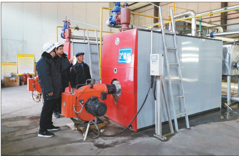
图为晋中市生态环境局榆次分局执法人员在晋龙泽养老院查看甲醇锅炉运行情况。晋中市生态环境局供图
